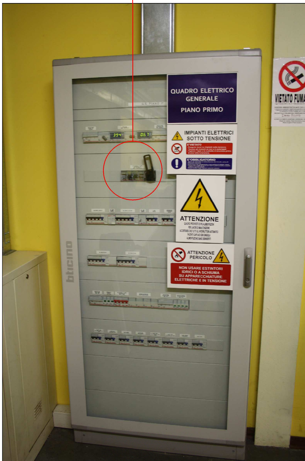
Quadro Elettrico Piano Primo
