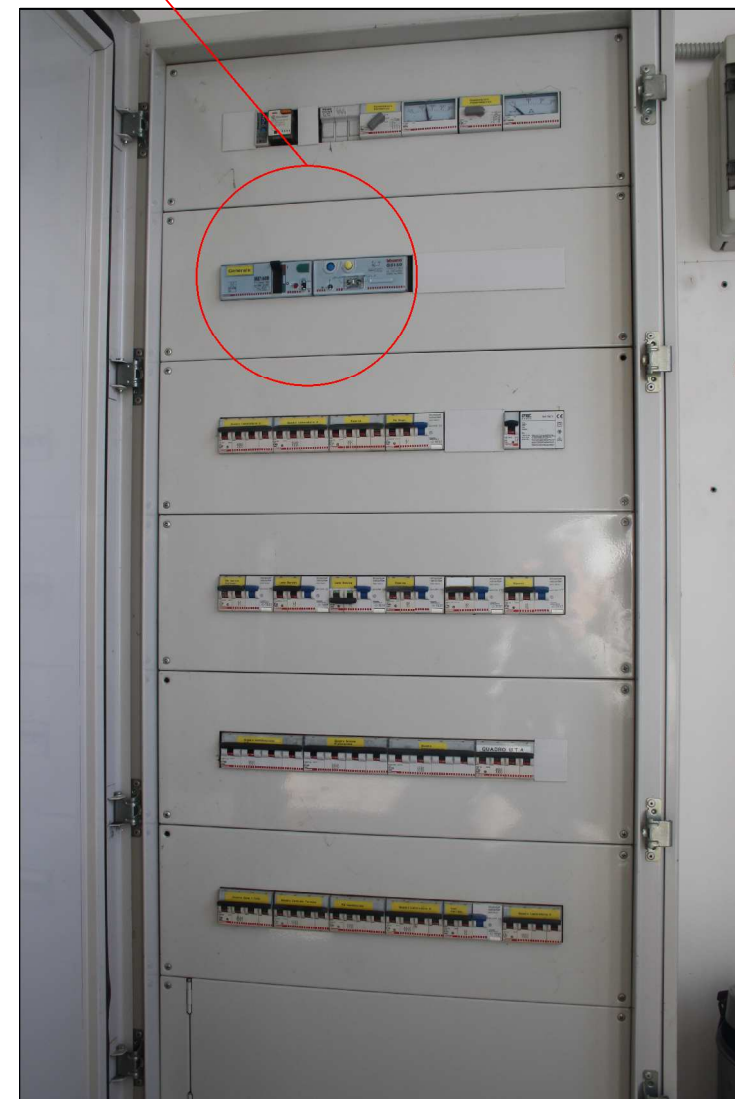
Int. Generale (Per togliere tensione portare la leva in posizione "0")
