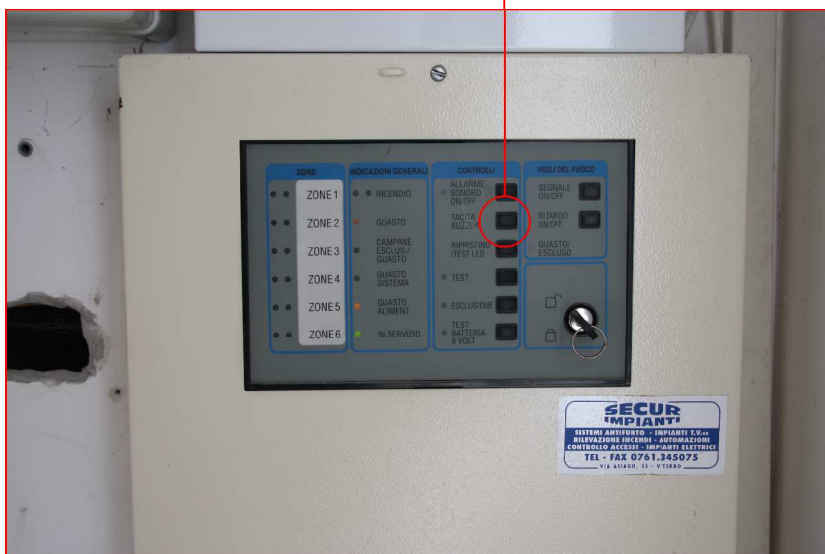
Centrale Rilevazione Incendi
