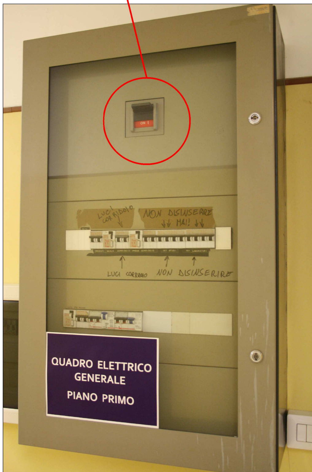
Quadro Elettrico Piano Primo
