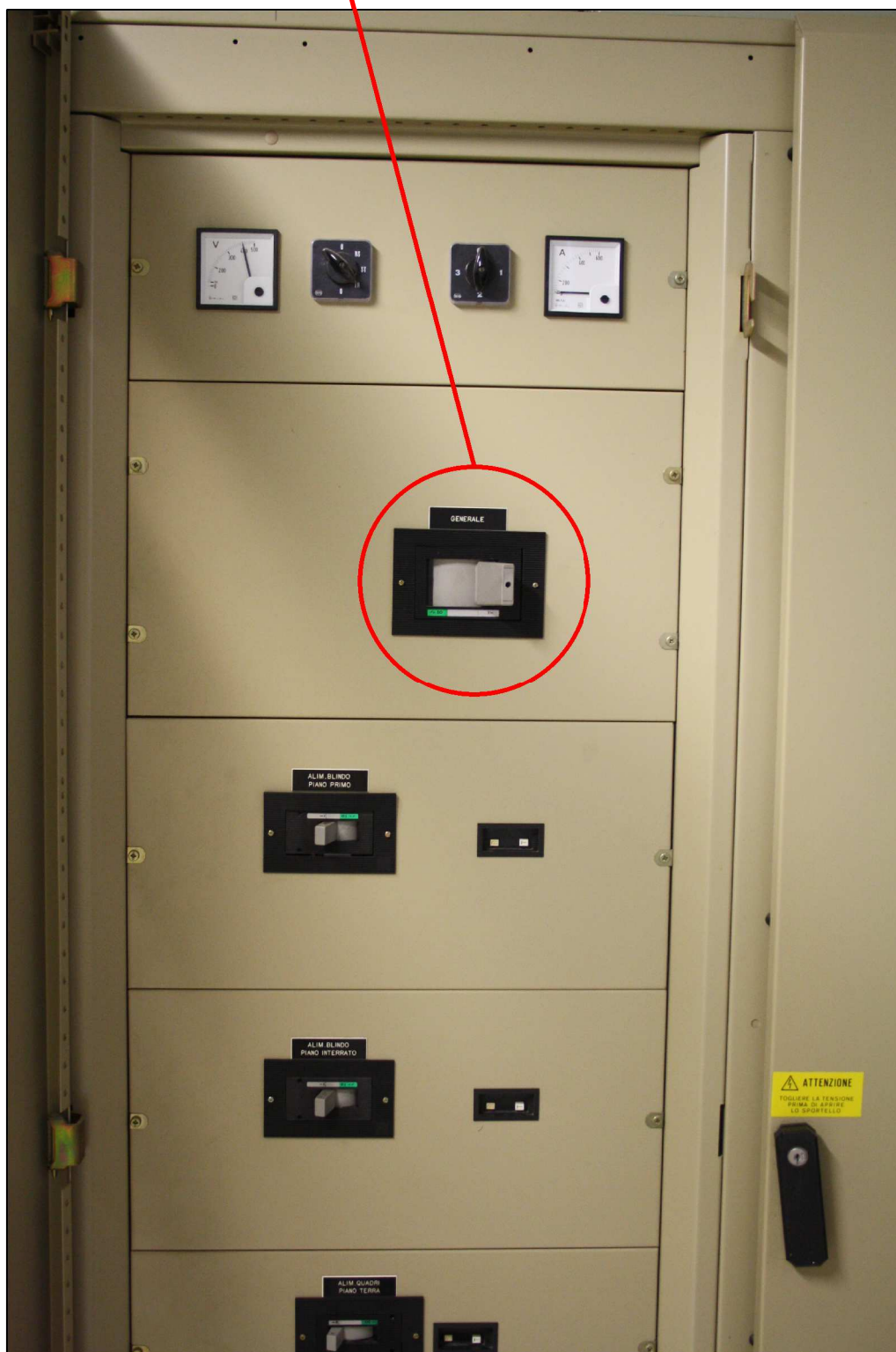
QUADRO ELETTRICO GENERALE + QPS
