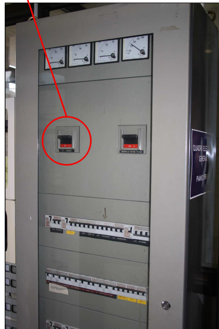
Quadro Elettrico Piano Terra
