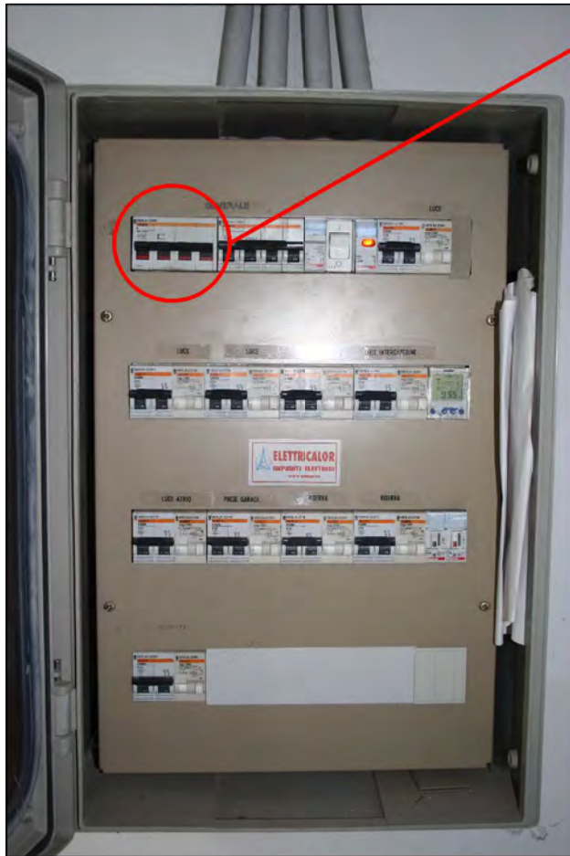
Quadro elettrico Piano Sem.
