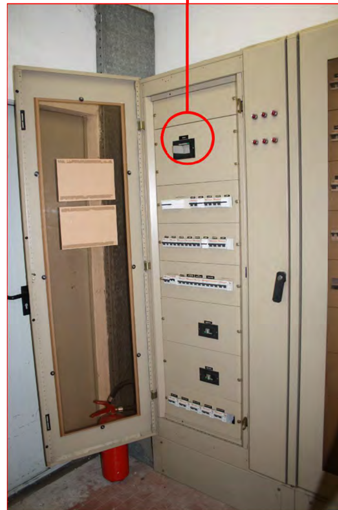
Quadro Elettrico Piano Seminterrato
