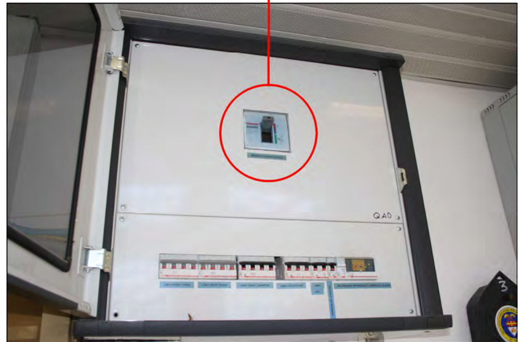
Quadro Elettrico Generale
