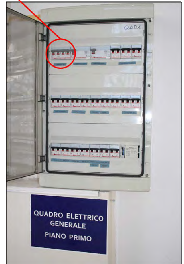
Quadro elettrico Piano 1°
