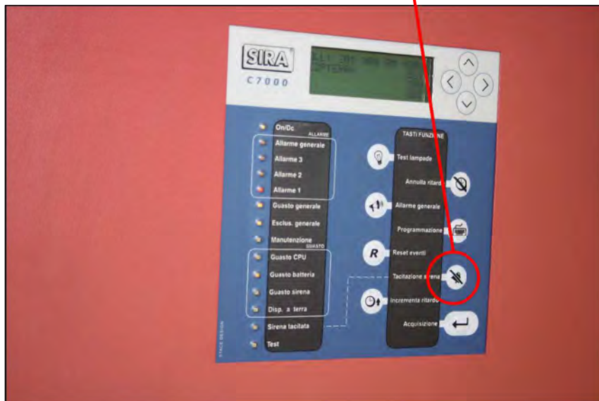
Centrale Rilevazione Incendi
