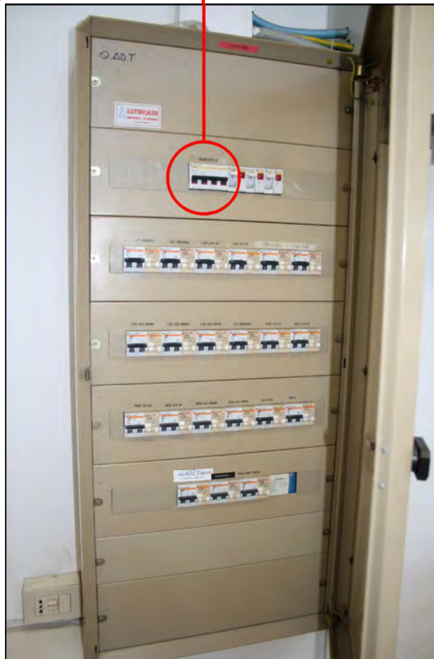
Quadro elettrico Piano Terra
