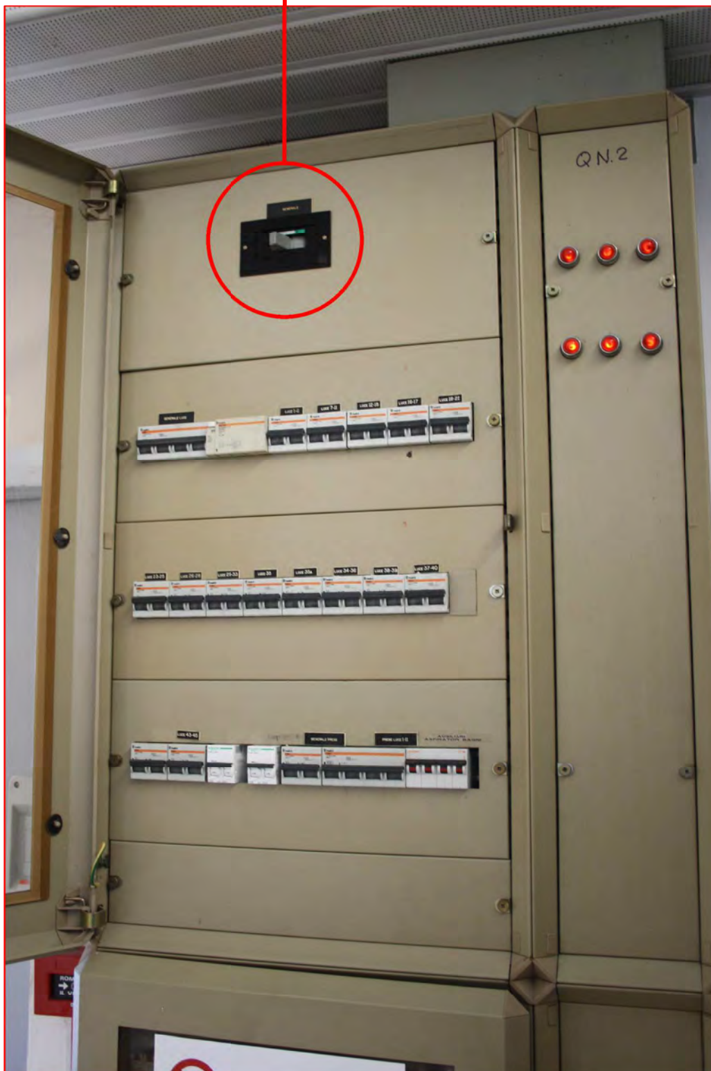
Quadro Elettrico Piano Secondo
