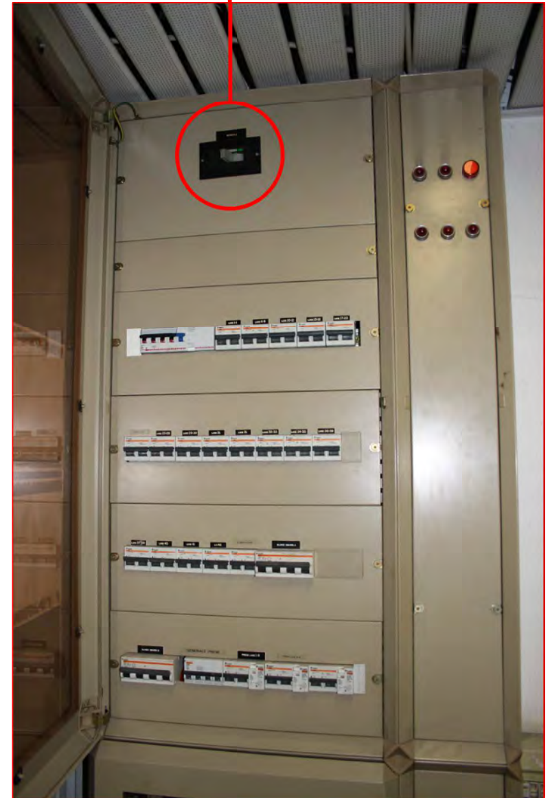
Quadro Elettrico Piano Terra
