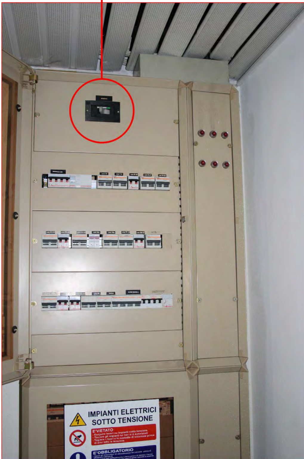
Quadro Elettrico Piano Primo
